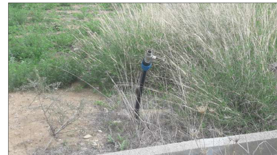
Foto 10 - Particolare rete idrica di adduzione ai lotti
