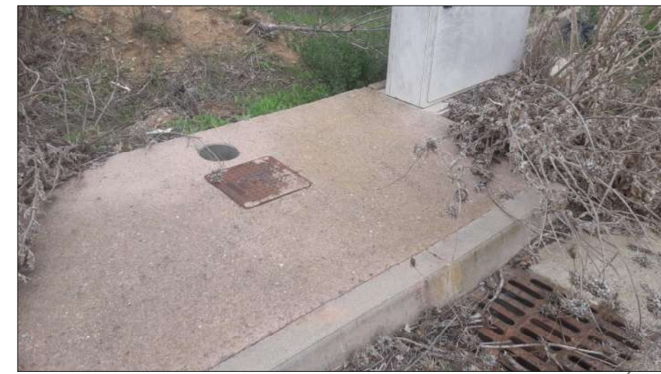
Foto 4 - Particolare pozzetto di derivazione con predisposizione palo
