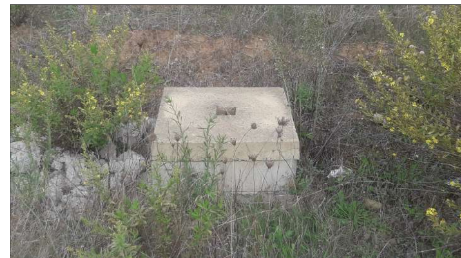
Foto 9 - Particolare pozzetto sifonato rete fognaria
